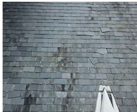
Les dégâts sur la couverture de l'église
